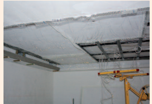
5 Bei der Montage der vorgefertigten und nummerierten Platten leistete der Plattenlift gute Dienste.
