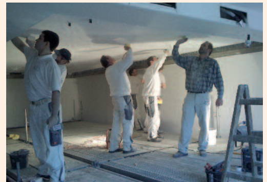
6 Die Glasfasern wurden erst nach dem Finish gekappt. Dies machte das Spachteln und Schleifen zeitaufwendig. (Bilder: Belz)
